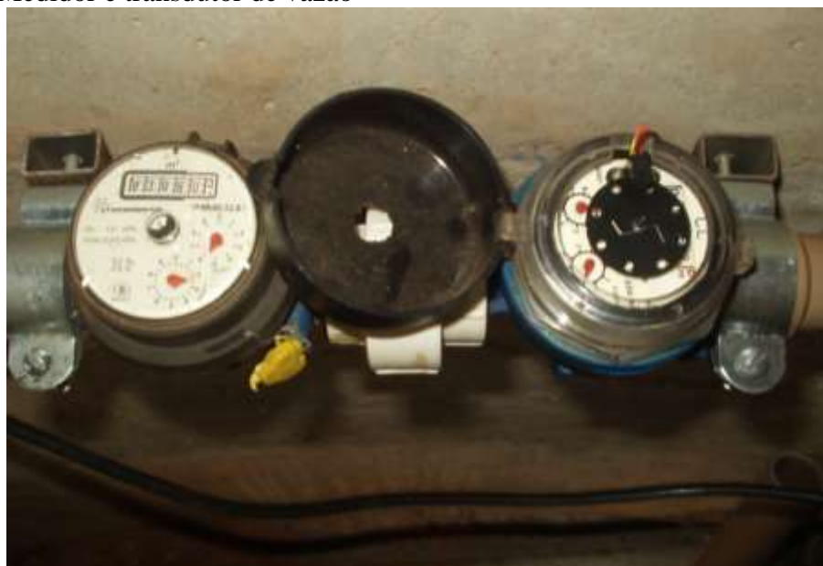
Figura 1 - Medidor e transdutor de vazão
